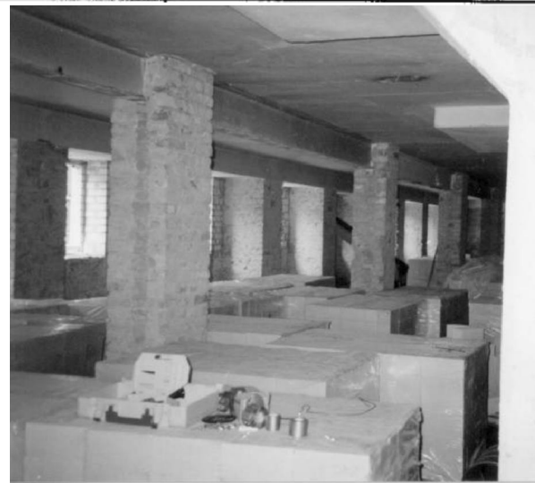
Nur die Pfeiler standen noch im Keller der Sporthalle. Aus dem ehemaligen Labyrinth wurden klare Konturen - zweckmäßig, hell, gut belüftet.
